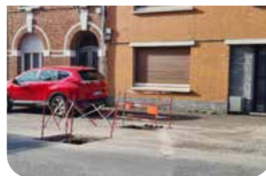
Les plaques d'égout rue du Général de Gaulle
