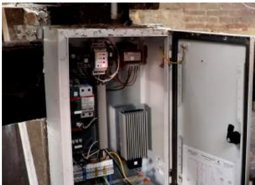
Boîtier installé dans le tout dernier étage de l'Hôtel de Ville
