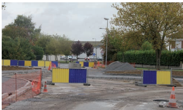
Création d'un giratoire face à la gendarmerie, route d'Estaires et rue Barra.
